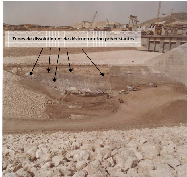
Figure 2 : Indices de dissolution, photos prises durant la construction du barrage (1982-1983) par A.T. Ayoub d'après Kelley et al. en 2007.
