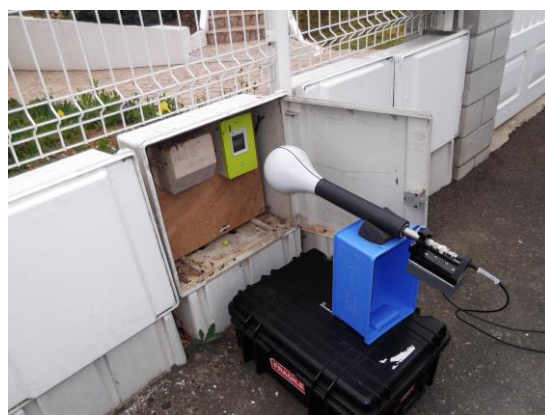
Photo 12. Champ électrique sur site - Antenne E isotropique
