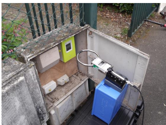
Photo 9. Champ magnétique horizontal sur site
