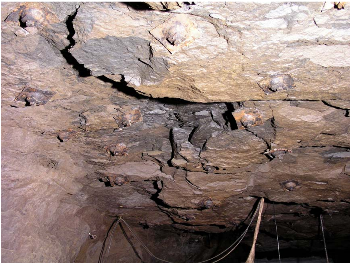
Photographie 1 : Chutes de toit après ennoyage puis dénoyage sur site pilote
