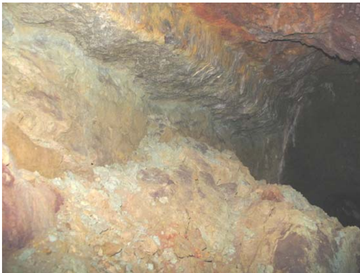
Photographie 3 : Dégradation des épontes dans une exploitation pentée (May-sur-Orne, 14)
