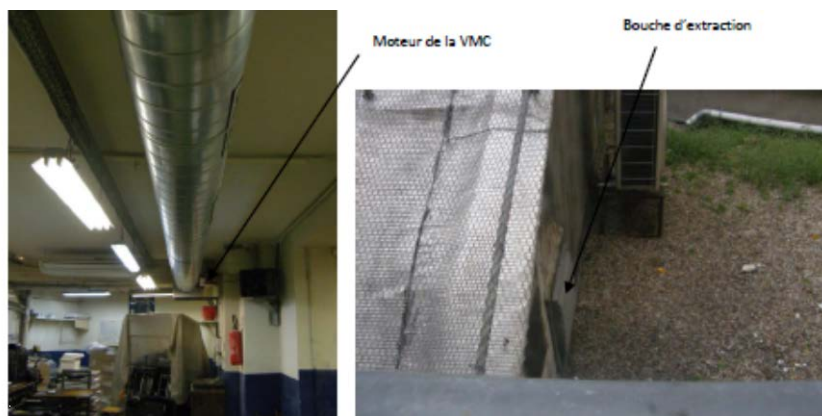
Figure 10 : Système de ventilation forcée de l'imprimerie
