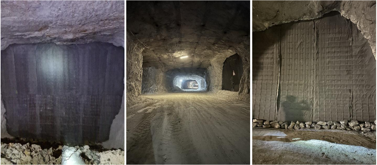
Figure 5. Quelques barrages de ventilation sur le site C
