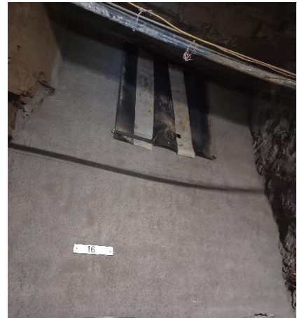
Figure 2. Barrage de ventilation
