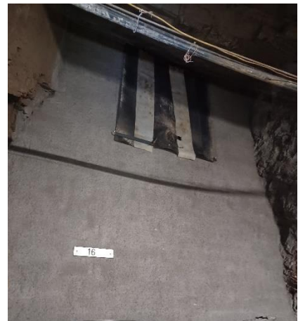
Figure 2. Barrage de ventilation
