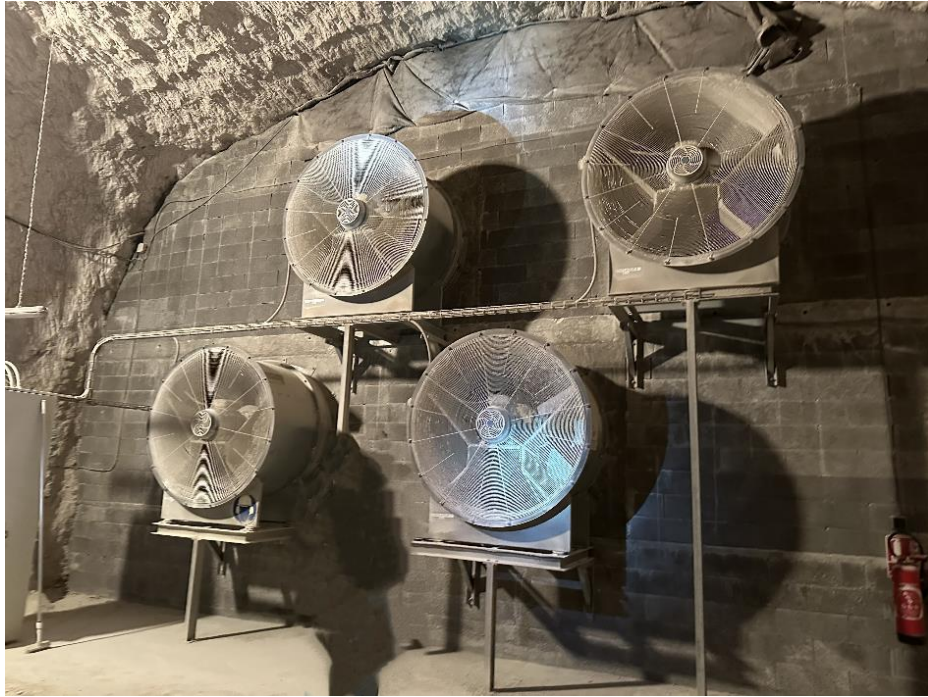
Figure 2. « Mur » de ventilateurs de ventilation primaire [source : carrière SAMIN]
