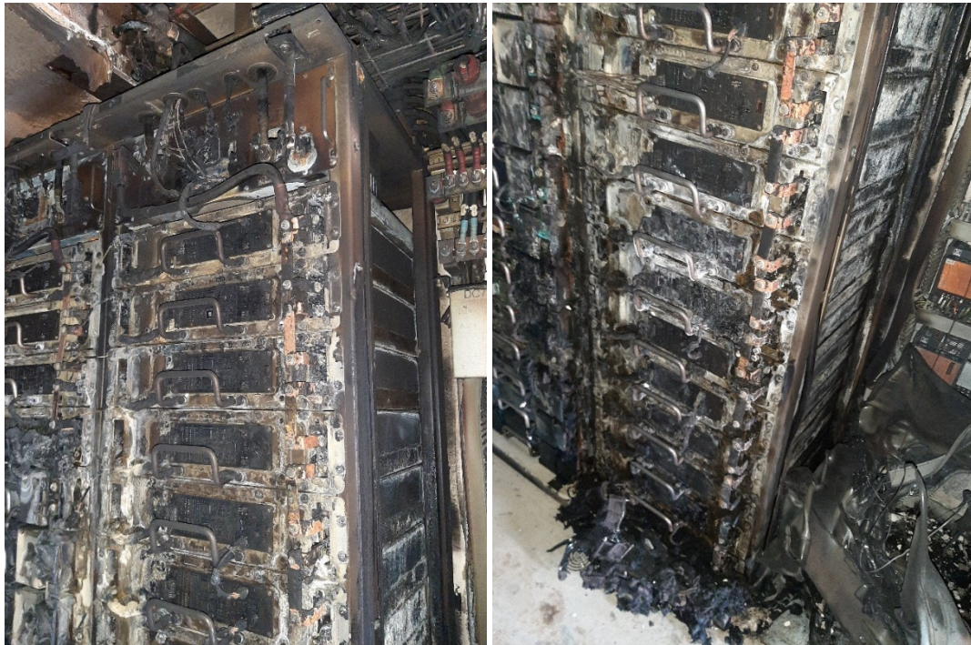
Figure 13 : Rack B3R1, le plus détérioré
