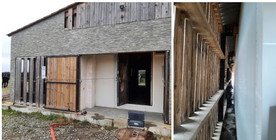
Figure 3 : Vue traversant du conteneur incendié (gauche) et espace entre conteneur et bardage bois côté ouest (droite)
