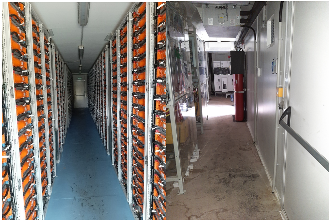
Figure 18 : Intérieur du conteneur ESS2 (gauche), et du conteneur de conversion de puissance (droite)
