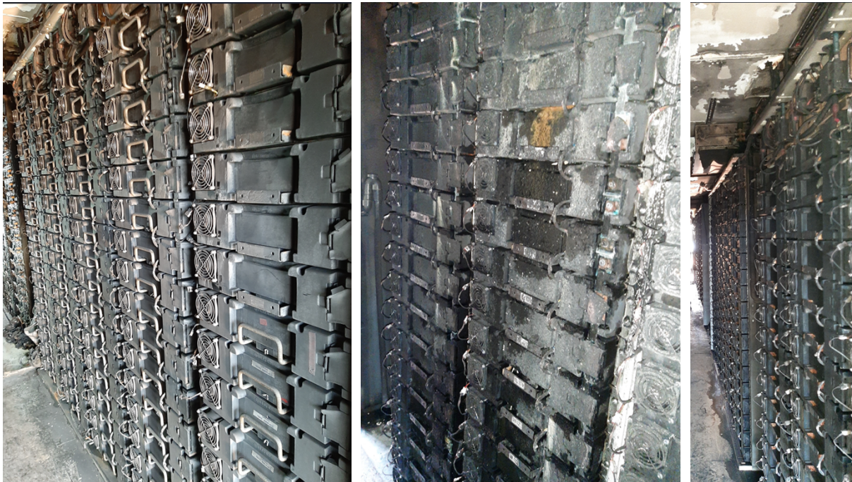
Figure 16 : Racks B3R6 à B3R9 et rack de réserve très peu impacté (gauche), racks B3R4 et B3R5 couverts de suie (milieu), rack du BSC 1 (droite)
