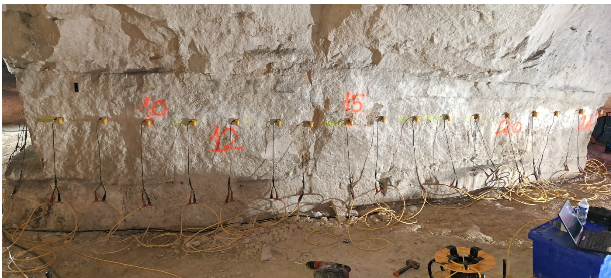
Figure 5 : Vue dans sa largeur (en haut) et dans sa longueur (en bas) du piliers ausculté (Carrière de Saint Maximin).
