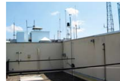
Dispositif de télésurveillance géotechnique installé sur la terrasse de la tour panoramique de Maxéville.
