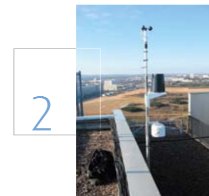
Station météorologique associée au dispositif de télésurveillance géotechnique installé sur la terrasse de la tour panoramique.
