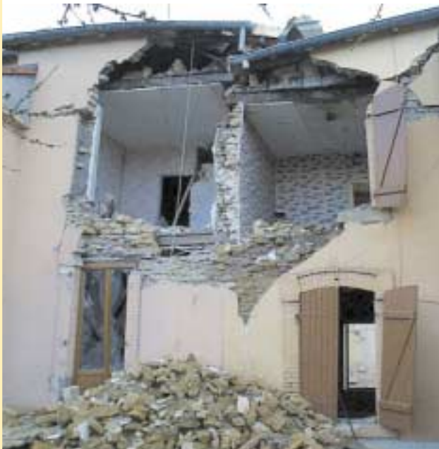
Conséquences sur le bâti des effondrements progressifs d'Auboué (54). Bassin ferrifère lorrain.
