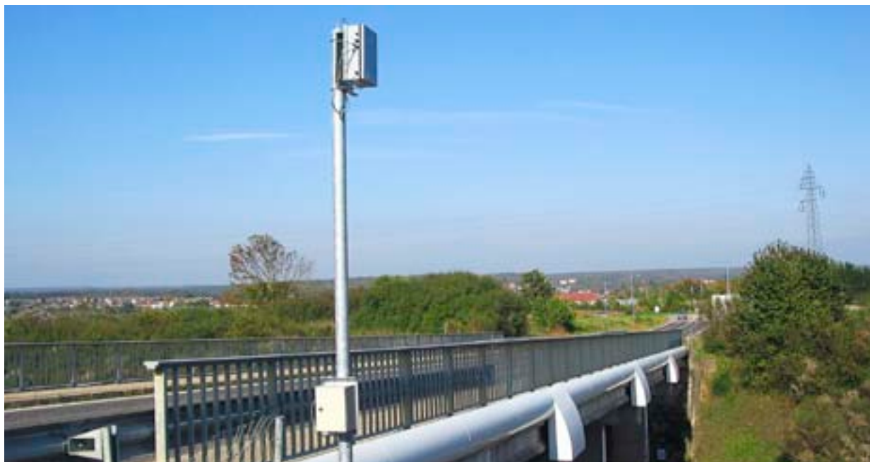
Radiotransmetteur installé sur l'autoroute A4 dans les zones minières.
