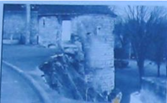
Effondrement des remparts
