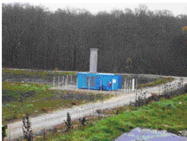
Figure 17 : Installation de plus grande capacité de traitement mise en place sur le site « B »
