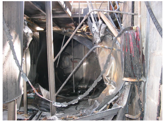
Vue de la cuve après l'explosion
