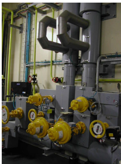
Vanne de sectionnement de circulation de phosgène (Photo A. Barbero)
