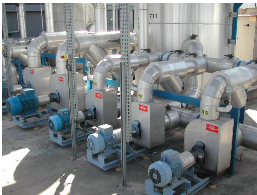
Redondance de moteurs de pompage d'un mono-fluide (Photo A. Barbero)
