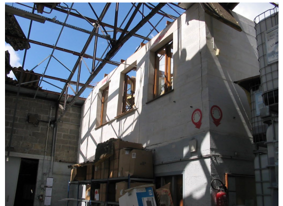
Destruction en toiture, à plus de 20 m
