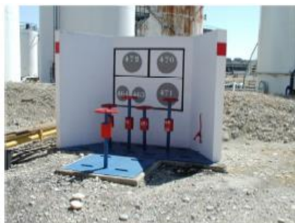
Figure 2: Vannes déluge manuelles protégées par un mur coupe-feu (Source : IFP Training)
