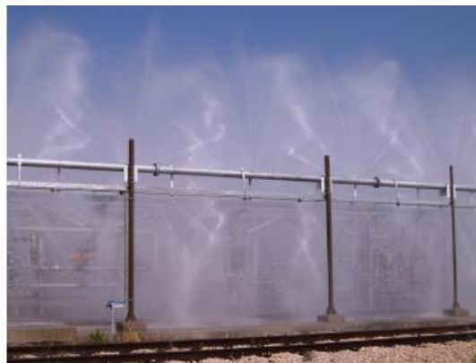
Figure 3: Rideau d'eau entre deux postes de chargement rail (Source : IFP Training)
