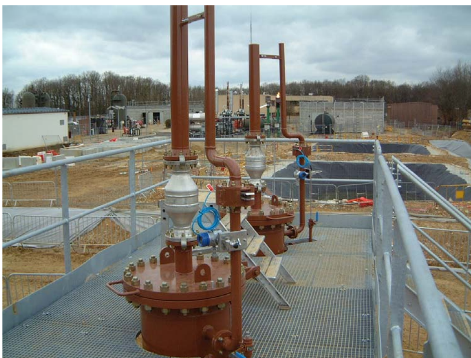
Figure 2 : Arrête-flammes en ligne installés sur un dégazeur d'une station de stockage de gaz
