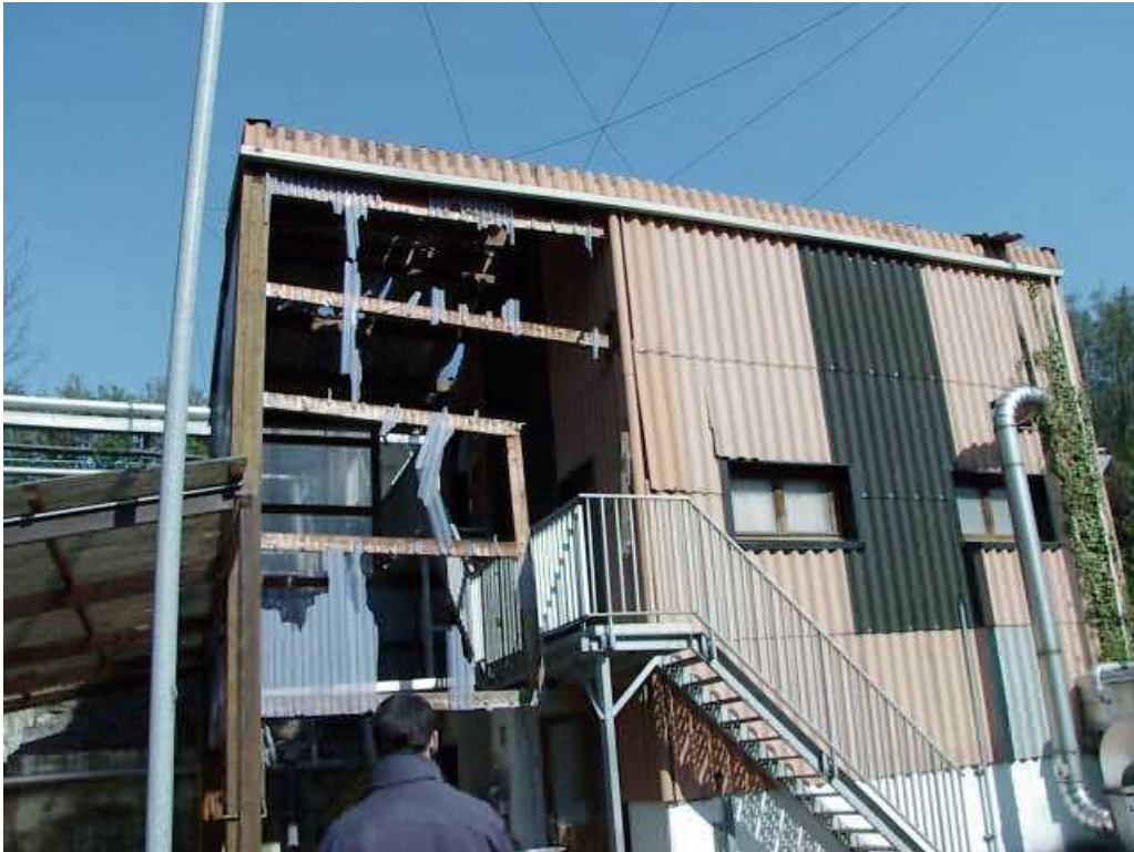
Figure 10 : Vue du bâtiment 18 du site Nitrochimie depuis un point situé à 90 m à l'Ouest de l'atelier 50
