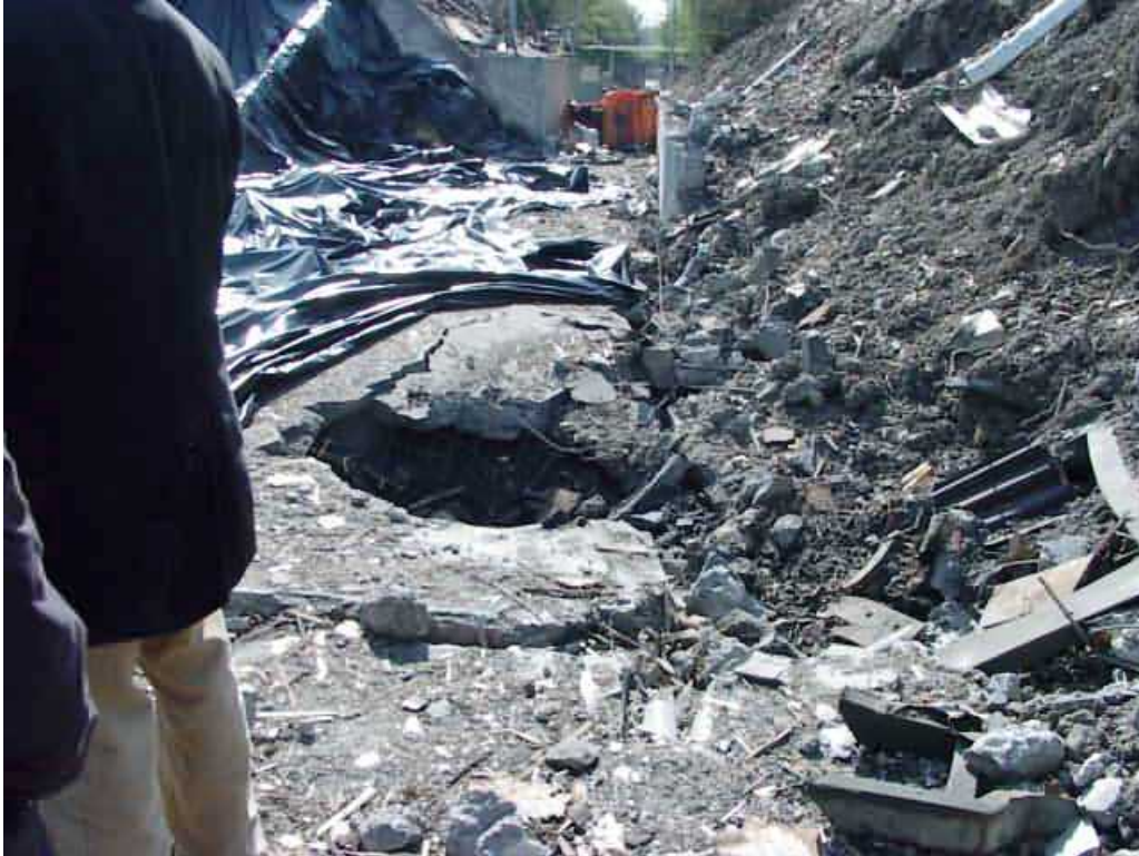
Figure 4 : Vue du cratère (point P114) devant l'atelier 50 du site de Nitrochimie
