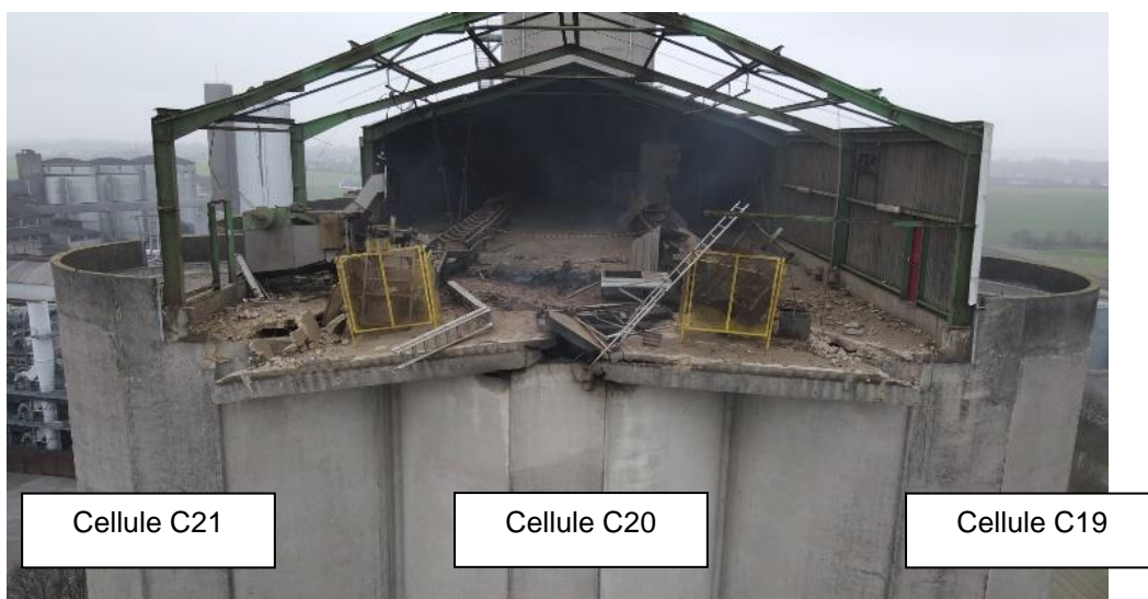
Figure 4 : Prise de vue du sommet du silo après l'accident du 06 janvier 2023 et le retrait des éléments de bardages de la galerie sur cellules [photo transmise par le BEA-RI]
