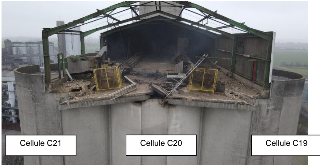
Figure 9 : Prise de vue du sommet du silo après l'accident du 6 janvier 2023 et le retrait des éléments de bardages de la galerie sur cellules
