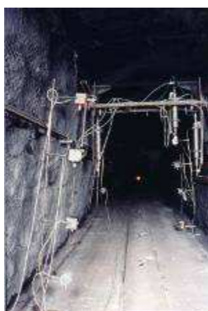
Galerie de 150 m (10 m 2 d'ouverture) pour tests de ventilation et/ou de détecteurs de gaz
