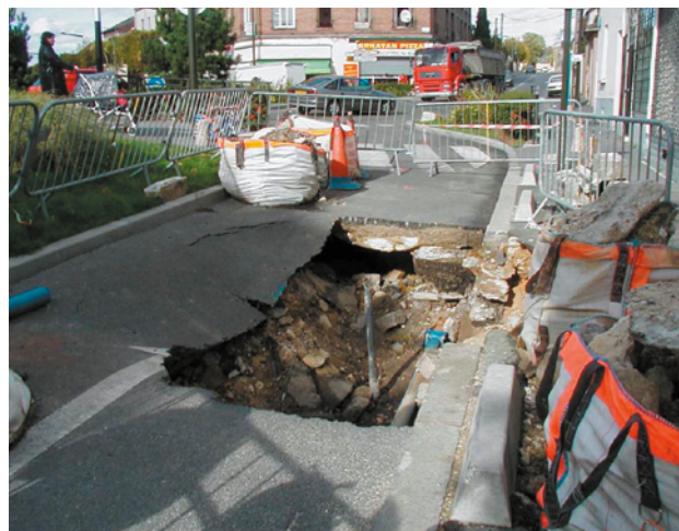
Photographie 8 : effondrement observé sur la commune de Villeteuseuse en lien avec la fuite du réseau d'assainissement (source : Cerema, juillet/octobre 2004)
